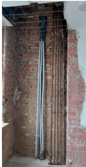
Hier war die Wand völlig durchfeuchtet
